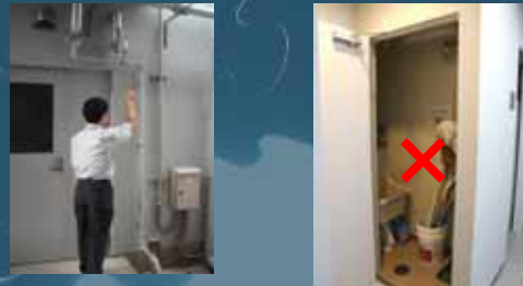
屋外緊急シャワー
